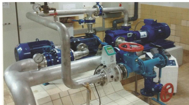
Blick ins Pumpenhaus. Im Hintergrund die zwei Kreislaufpumpen
